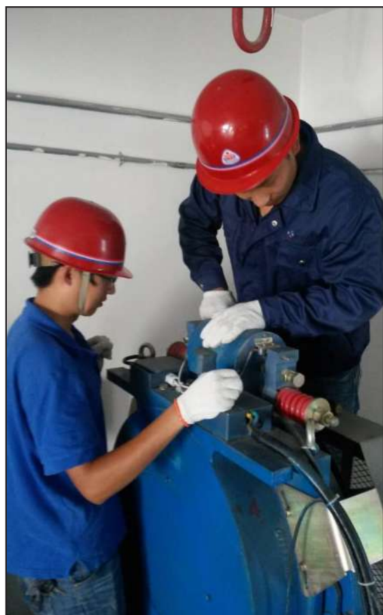
图为新禾公司电梯维保人员检修
